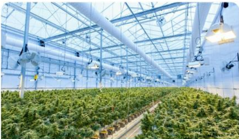
温室大棚系统电源监控
