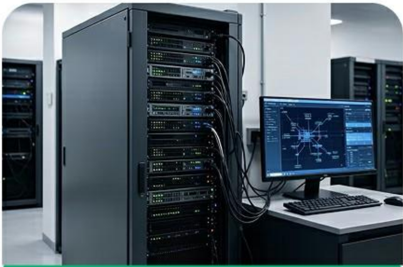
机房/数据中心
