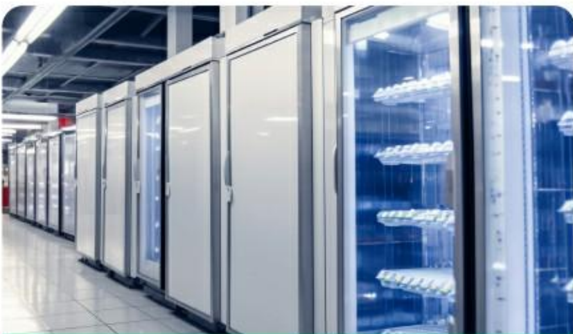
药品生鲜冷柜电源监控
