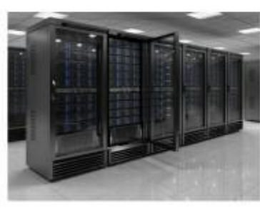
数据中心/机房
