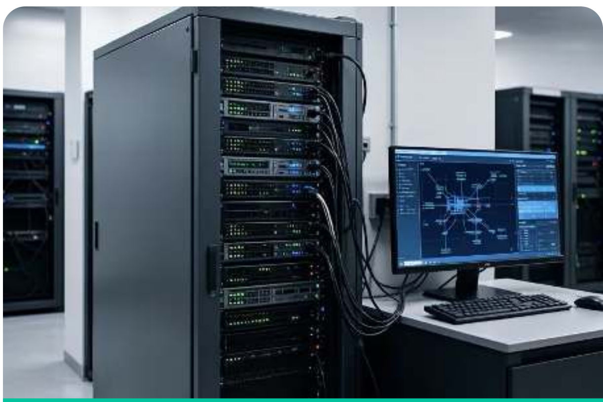
机房/数据中心
