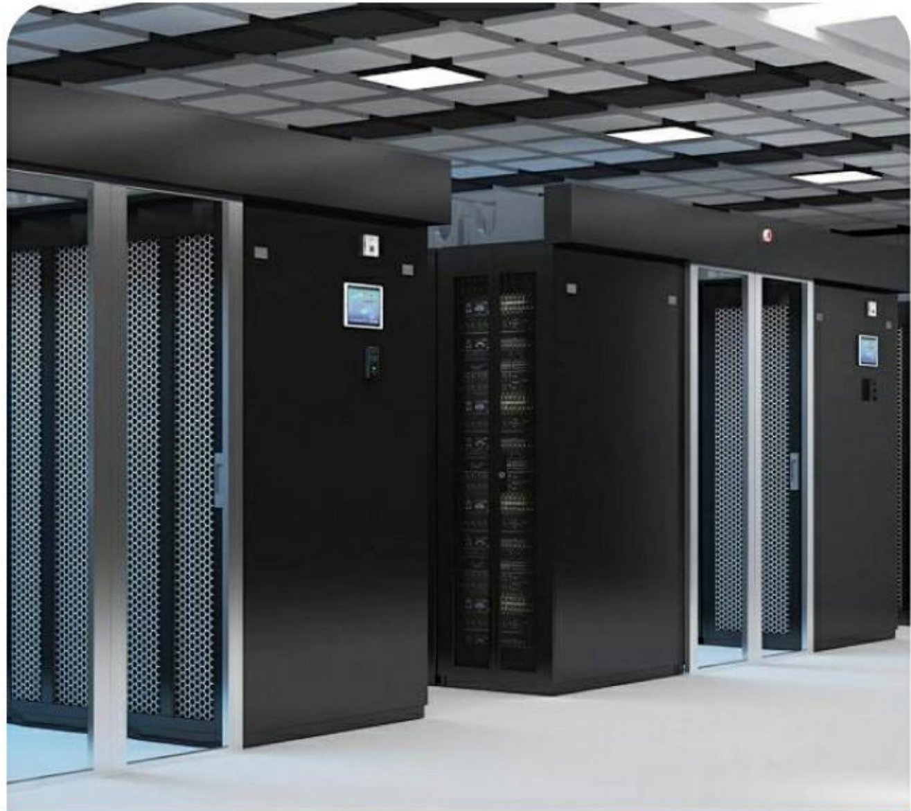
数据中心/机房
