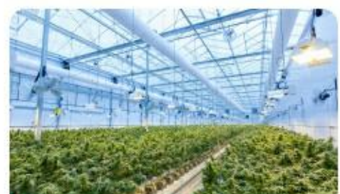
温室大棚系统电源监控
