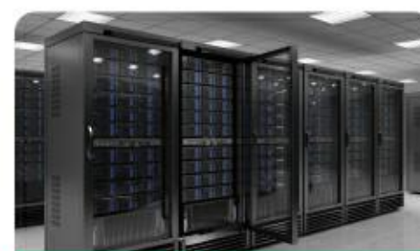
数据中心/机房
