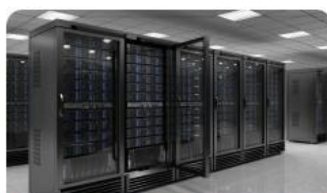
机房/实验室电源监控
