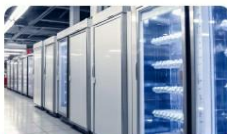
药品生鲜冷柜电源监控
