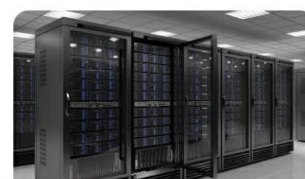
数据中心/机房
