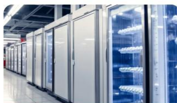
药品生鲜冷柜电源监控
