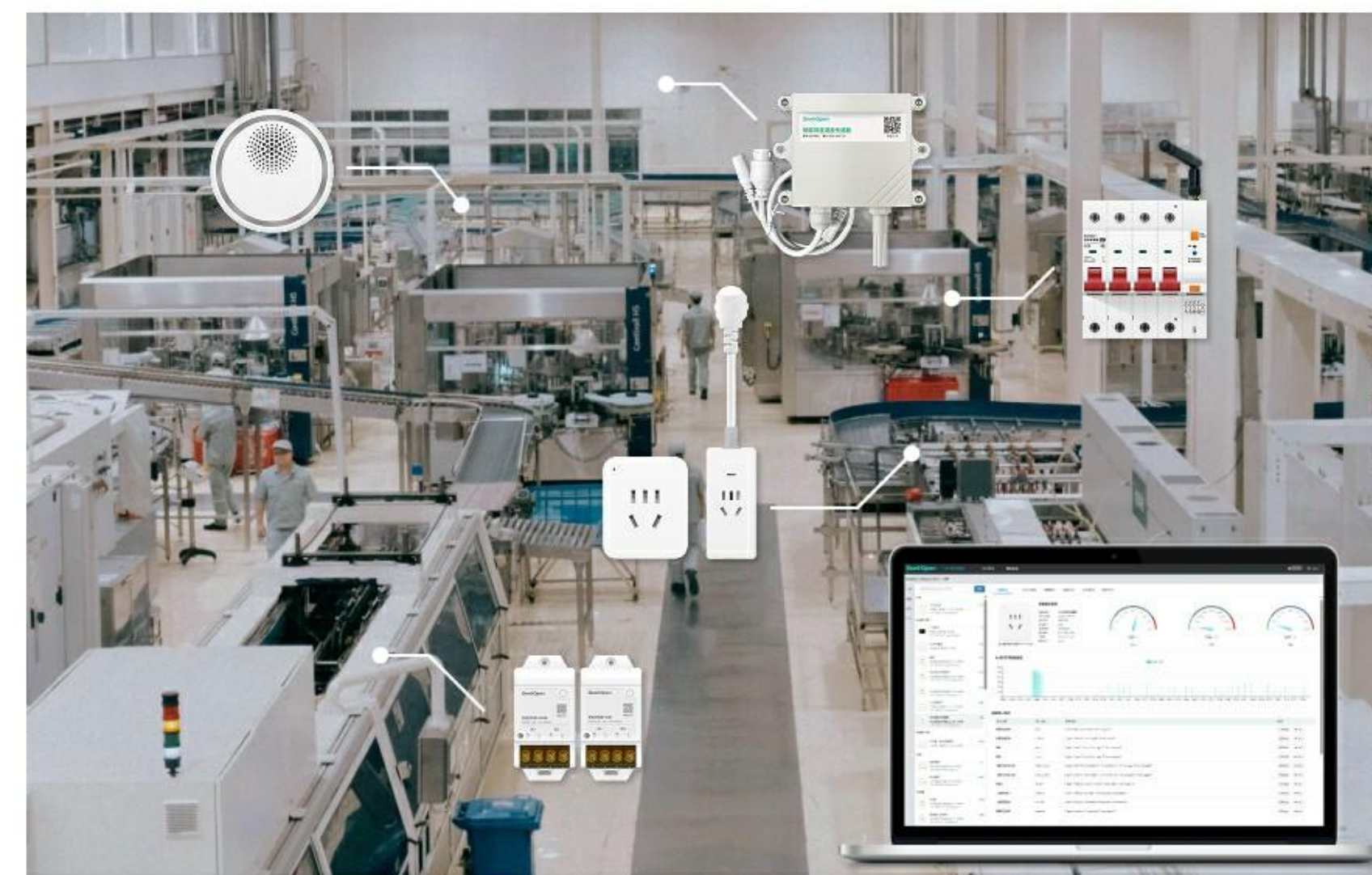
工厂车间用电监控
