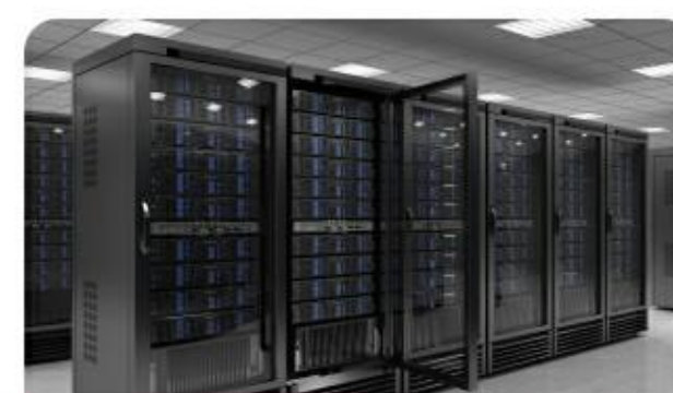
数据中心/机房
