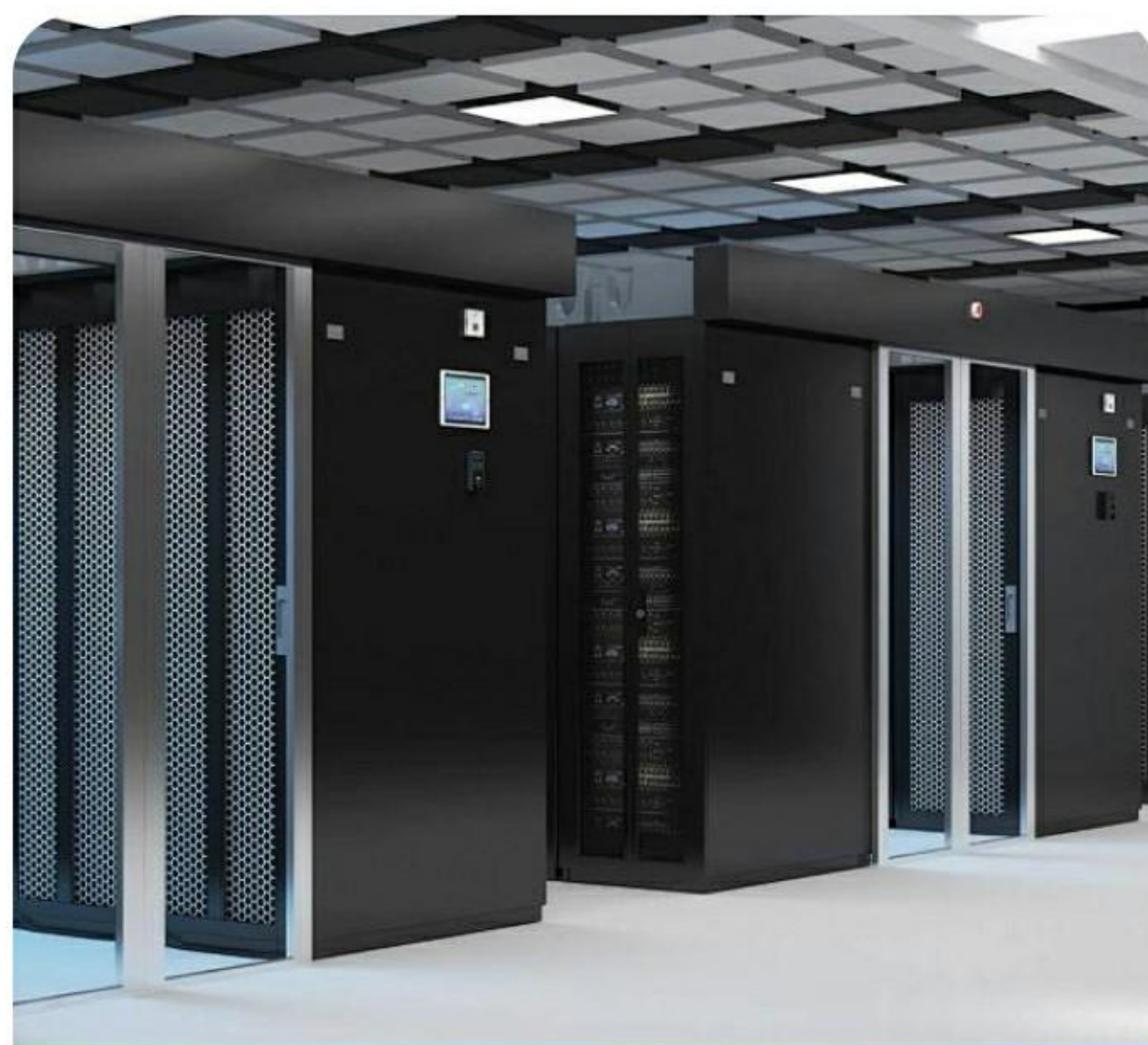
数据中心/机房
