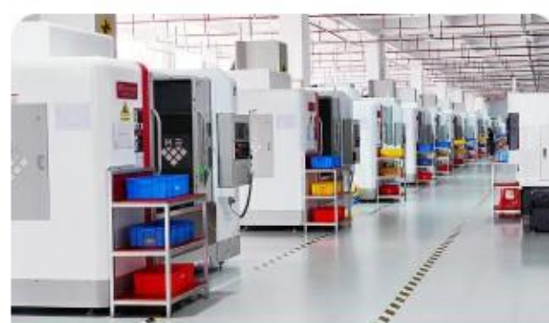
工厂车间安防电源监控
