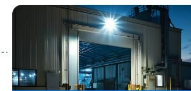
建筑工地临时供电
