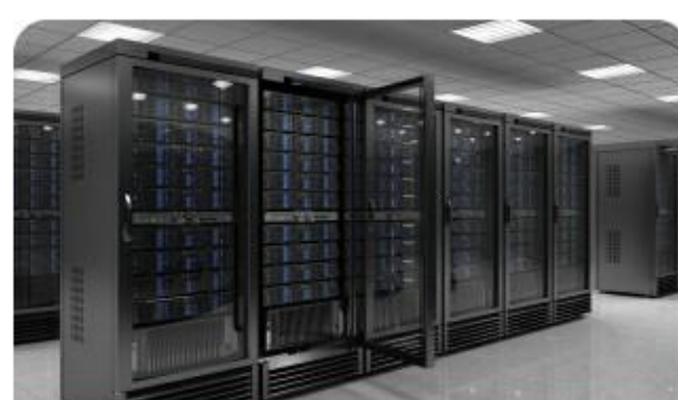
机房/实验室电源监控
